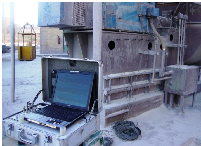
شکل ۹- آزمون مودال عملیاتی یک فن در مجتمع فولاد مبارکه
